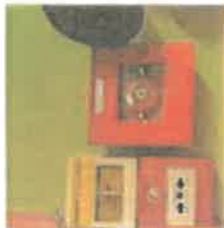
Coupure électrique et VMC à R+1 et même endroit à R+2
