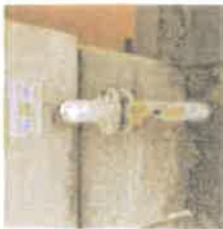
Vanne GAZ devant bâtiment chauffé
