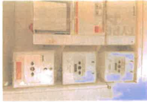
Ventilation et électricité - coupure
