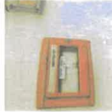
Coupeur panneaux photovoltaïques dans le local antérieur
